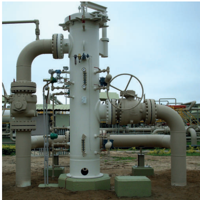
Instrumentación de Filtro Vertical Coalescente Planta Colpa Petrobras
