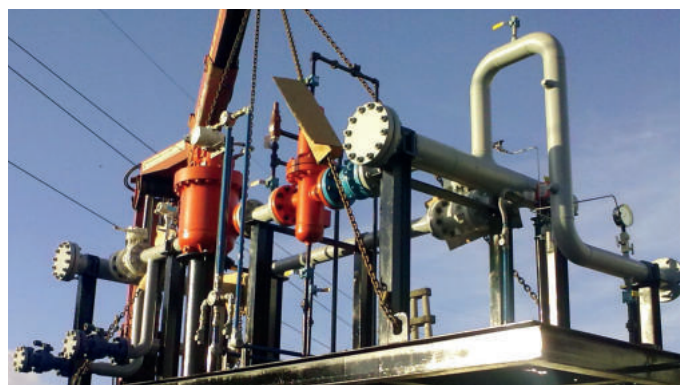
Puente de Medición Fiscal de Líquidos Refinados y GLP Montado en SKID
