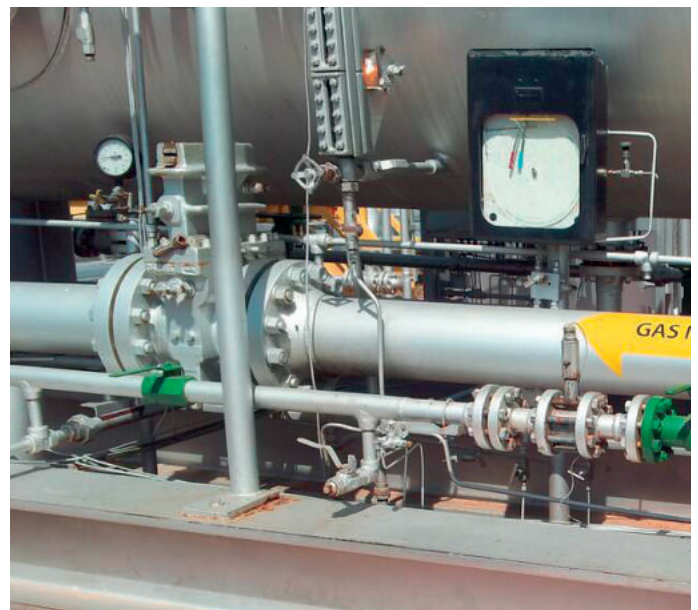
Sistema de Medición de Líquidos y Gas Planta El Porvenir (oxy-vintage)
