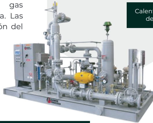
Sistema de Acondicionamiento de Gas Combustible
